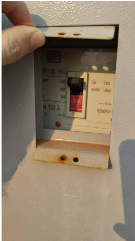
Imagem do disjuntor geral
